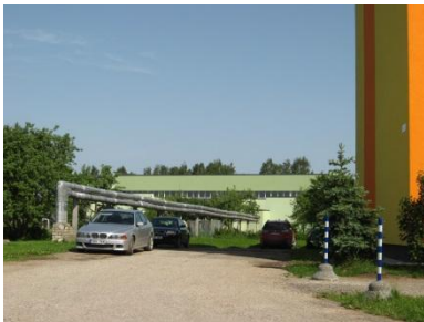
Maapealne soojusvõrgu osa.
