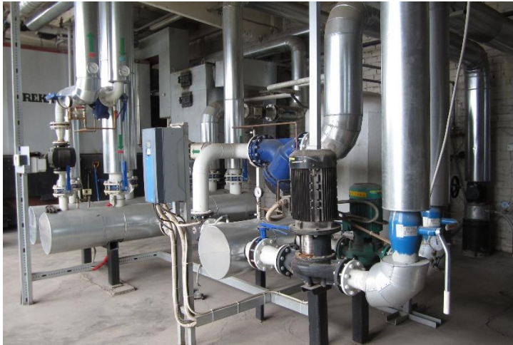
Joonis 3.3. Kolga kaugkütte võrguvee pumbad
