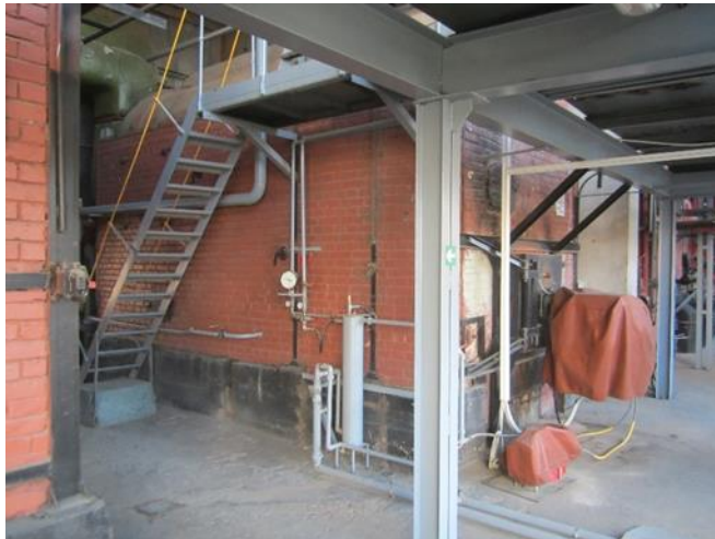
Joonis 2.3. Küttemasuudikatel DKVR-4 (3 MW)
