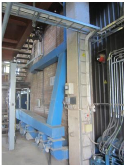
Joonis 2.6. Vabriku katlamaja DKVR-10 katel
