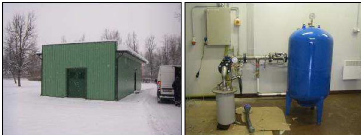
Joonis 4.6 Eha puurkaev-pumpla välis- ja sisevaade
