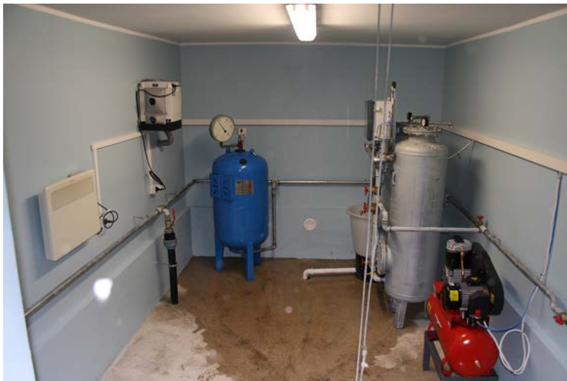
Joonis 10. Rääbise puurkaevpumpla sisevaade
