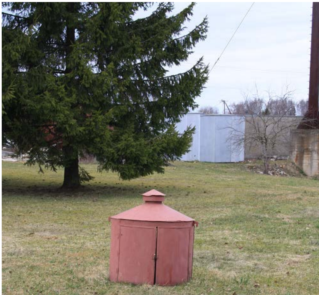
Joonis 6. Sadala puurkaevpumppla välisvaade (taustal on näha seadmeid majutav endine garaažihoone)
