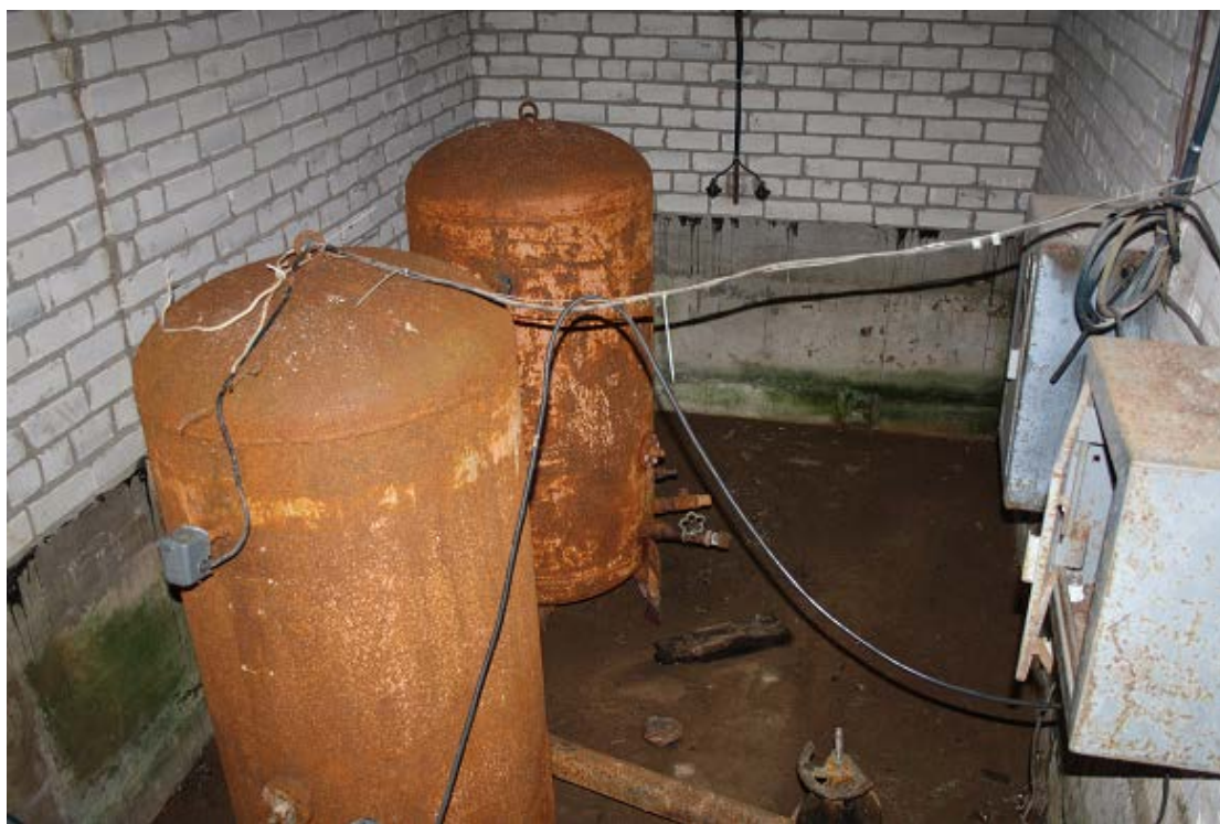
Joonis 12. Kantküla puurkaevpumpla sisevaade
