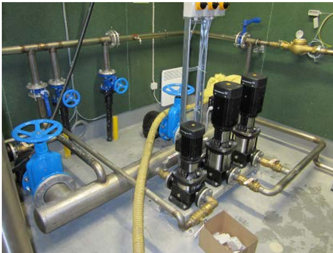
Joonis 3. Torma puurkaevpumpla sisevaade
