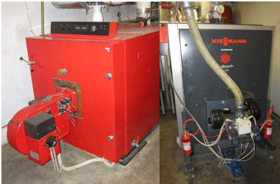
Joonis 5.2. Harku lasteaia katlamaja katlad
