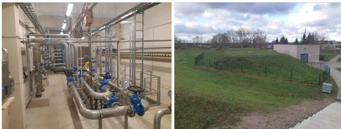
Joonis 6.1 Kellamäe pumpla
