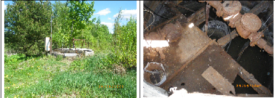
Joonis 6. Kolga-Jaani aleviku reoveepumpla. Fotod: OÜ Alkranel 25.05.2009.
