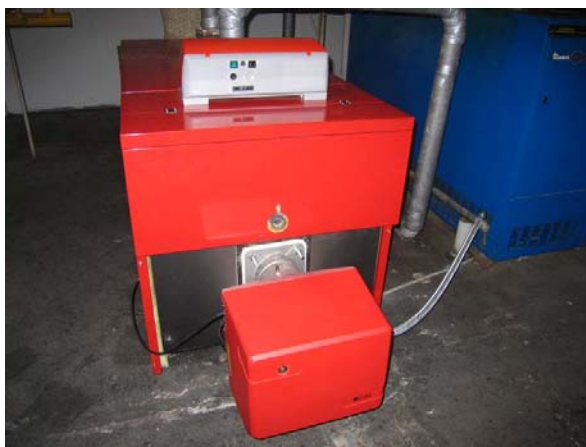
Pilt 3 -0,3 MW võimsusega katel
