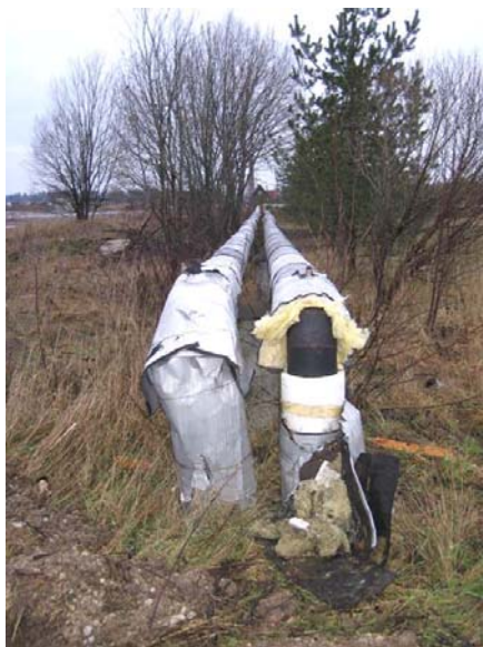
Pilt 7 -Katkine soojustorustiku isolatsioon
