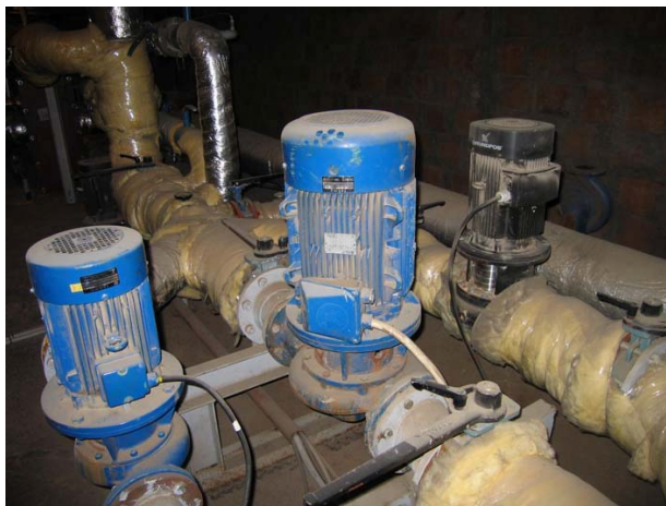
Pilt 5 -Kaugkütte tsirkulatsioonipumbad
