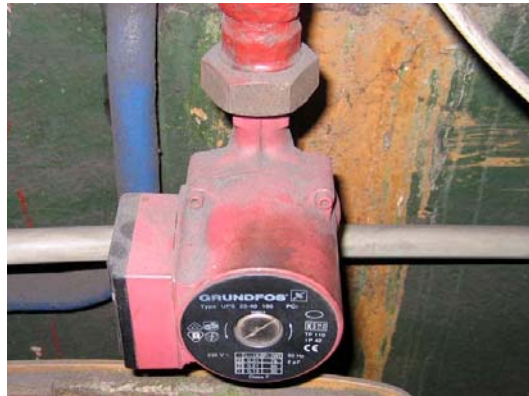
Pilt 5-Sooja tarbevee tsirkulatsioonipump
