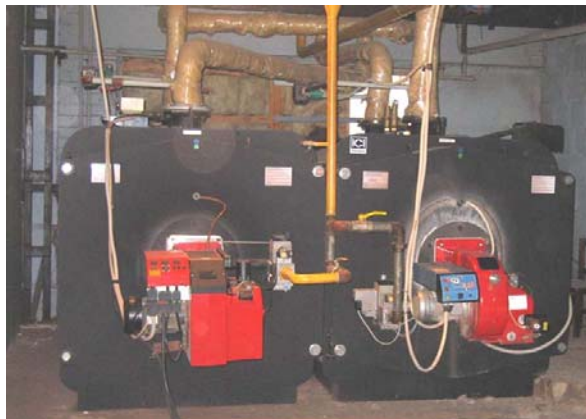
Pilt 2 -Kaks katelt ühikvõimsusega 1.6 MW.
