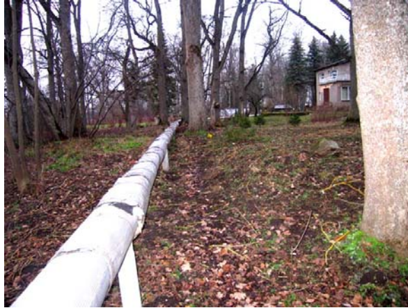
Pilt 7 -Maapealne soojustorustik, mis varustab 2-korruselise hoonet
