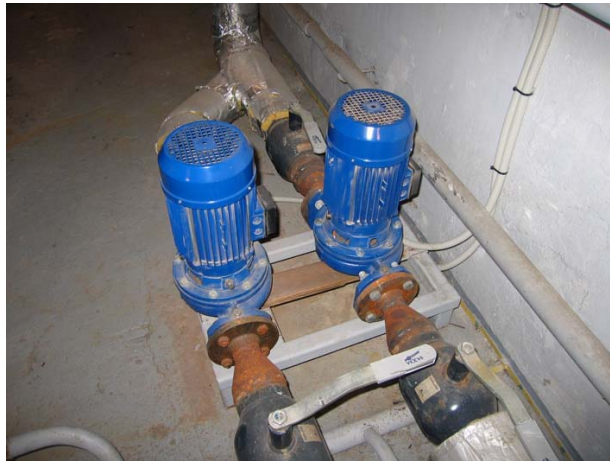
Pilt 9 -Kaugküttetorustiku tsirkulatsioonipumbad
