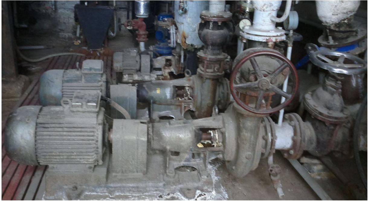
Joonis 4.6. Linnakatlamaja pumpsüsteem
