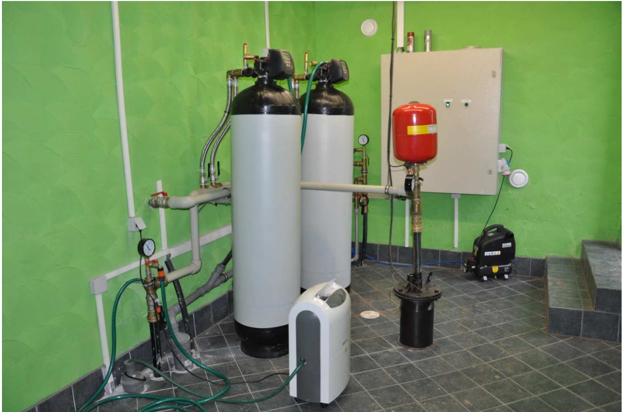
Foto 6: Õisu uue puurkaevu veetöötlus
