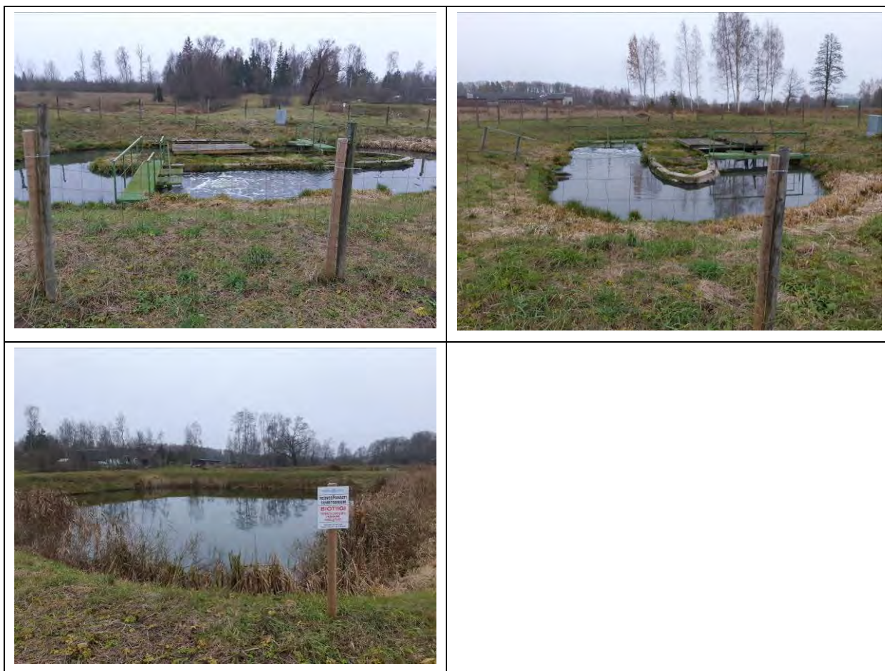
Joonis 9. Vana-Antsla aleviku reoveepuhasti. Fotod: OÜ Alkranel 07.11.2018.
