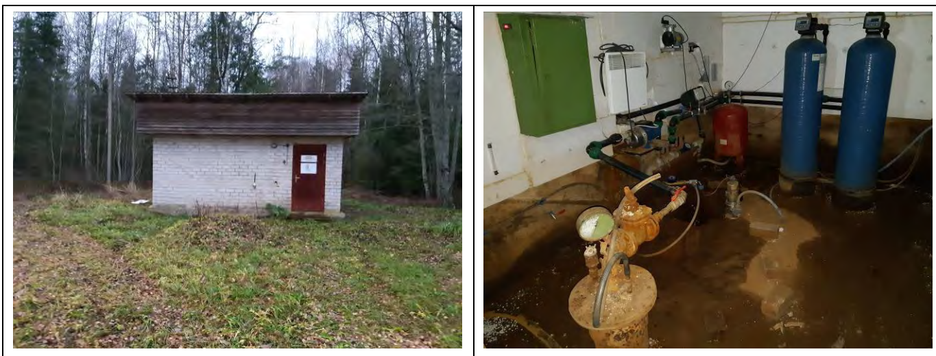
Joonis 20. Visela küla puurkaev-pumpla (katastri nr 10732) ja veetöötusjaam. Fotod: OÜ Alkranel 07.11.2018.
