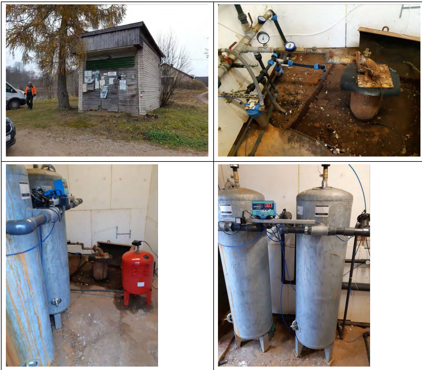
Joonis 18. Vaabina küla puurkaev-pumpla (katastri nr 10742) ja veetötlusjaam. Fotod: OÜ Alkranel 07.11.2018.
